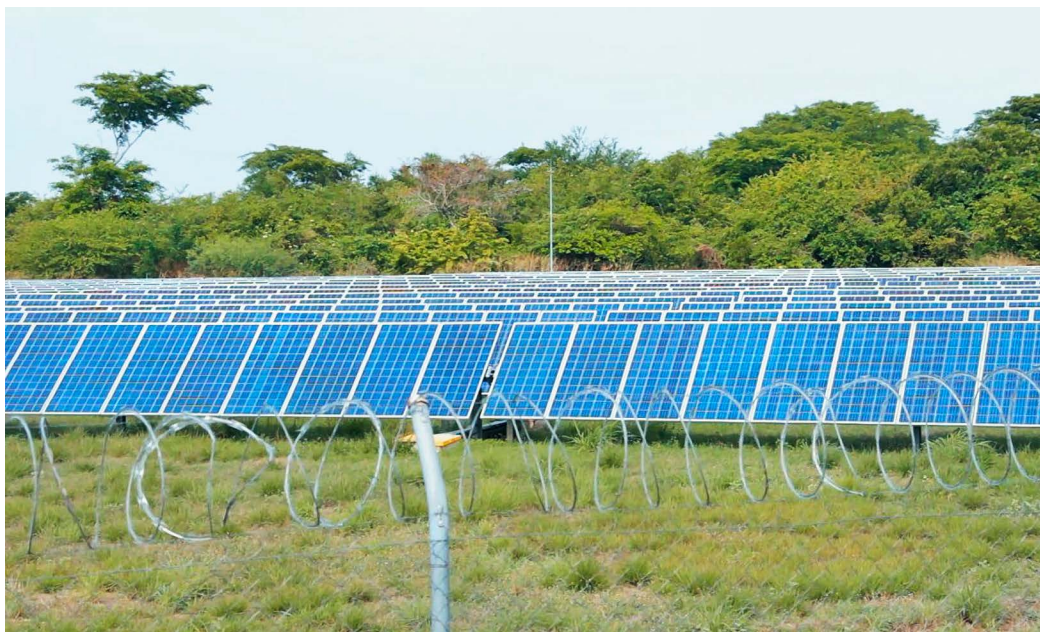
Los paneles solares del proyecto Los Prados suministran electricidad al Sistema Nacional Interconectado de Honduras. Foto: Red de Abogadas Defensoras de Derechos Humanos (RADDH)
